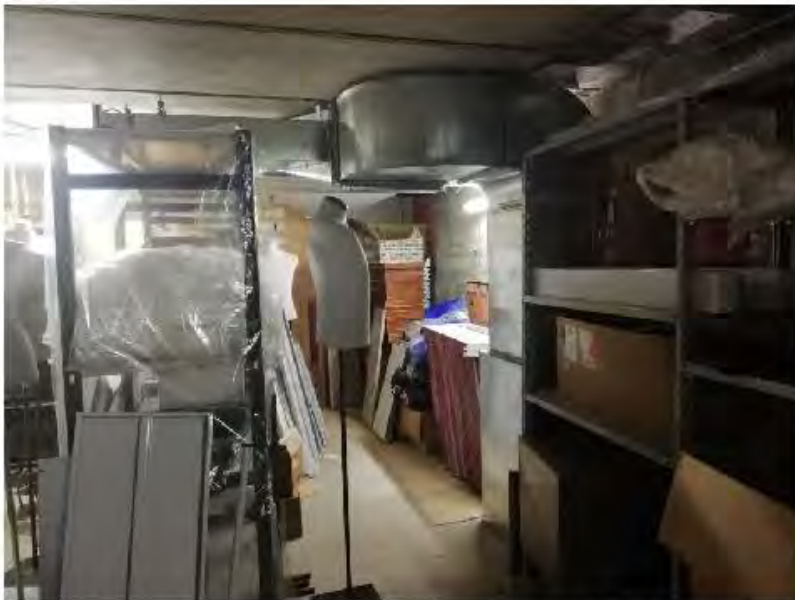
Locale Ripostiglio (3)- zona tecnica
