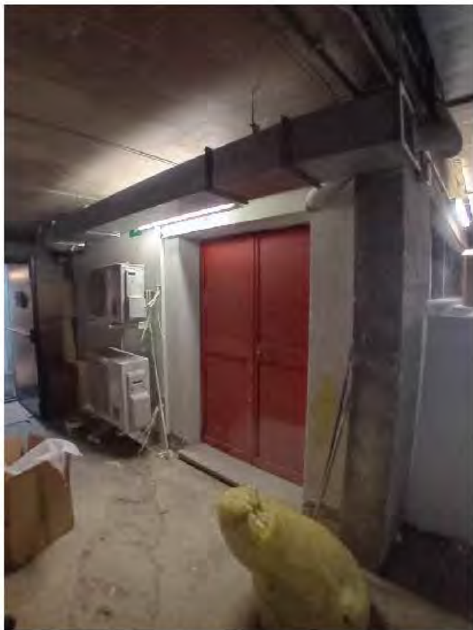
tubazioni della ventilazione da spostare
