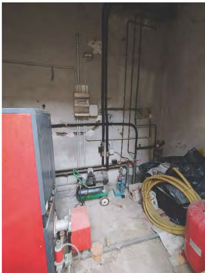
Locale tecnico (vista 1)
