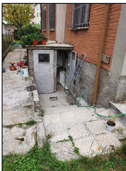
FOTO 27 - CENTRALE TERMICA CONDOMINIALE
