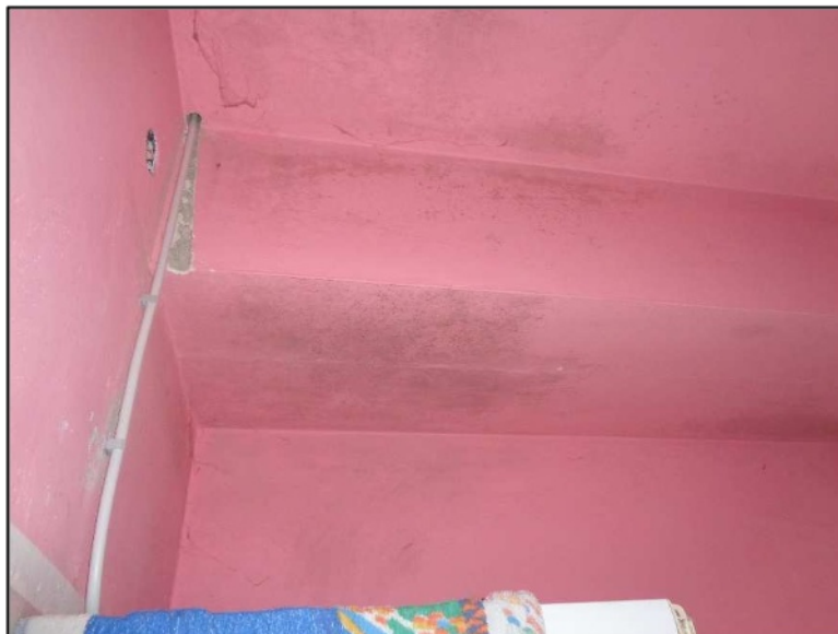
FOTO 16 – MUFFE/CONDENSE SERVIZIO IGIENICO
