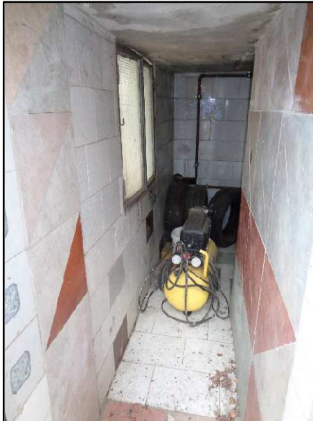
FOTO 28 – INTERNO CENTRALE TERMICA CONDOMINIALE
