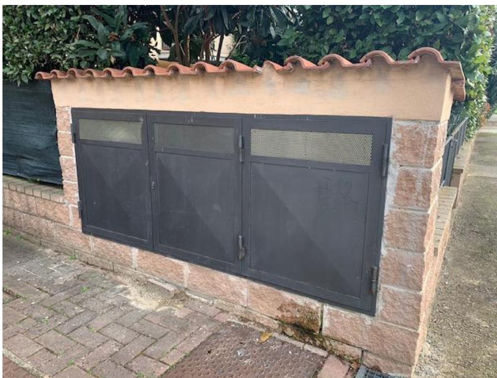
FOTO 17 – Vista zona vano contatori
