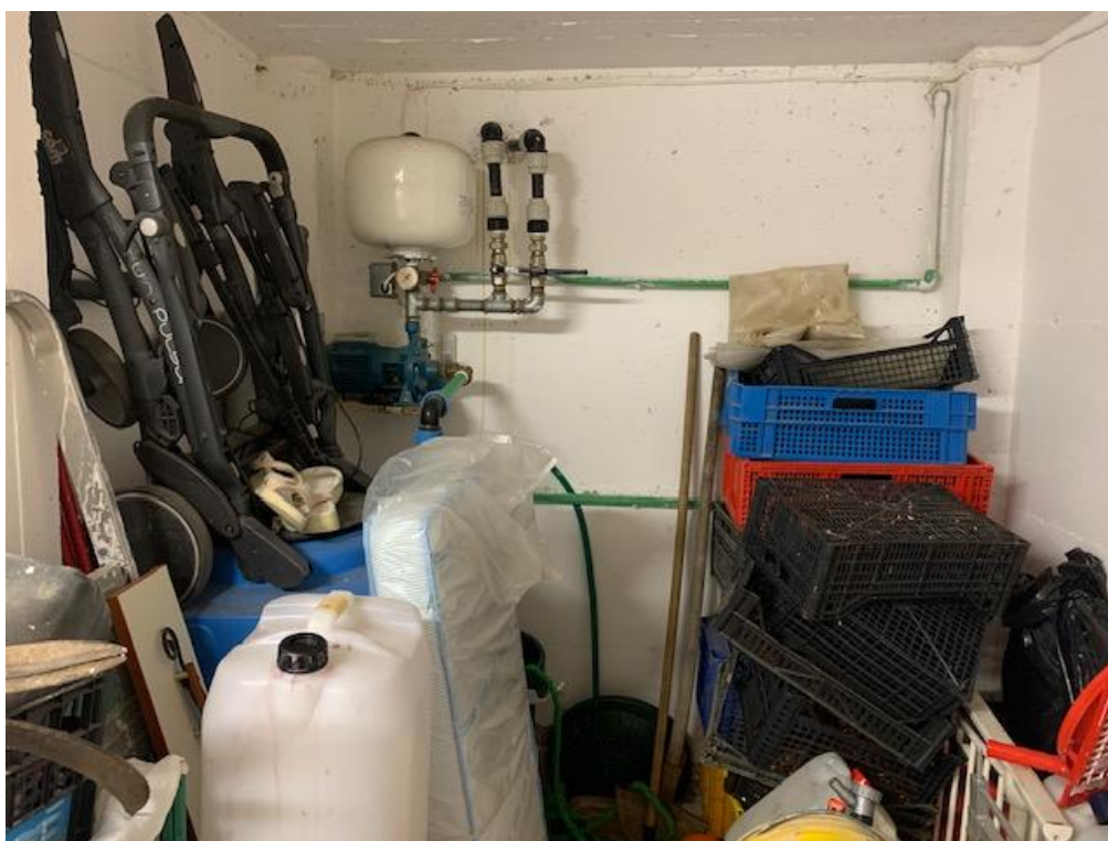
FOTO 23 – Vista dell'impianto autoclave ubicato nell'autorimessa
