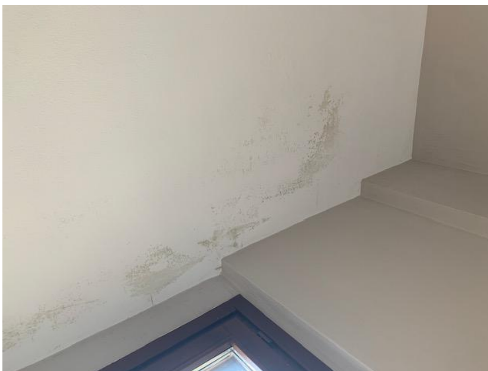
FOTO 20 – Vista soffitto ingresso con ammaloramento
