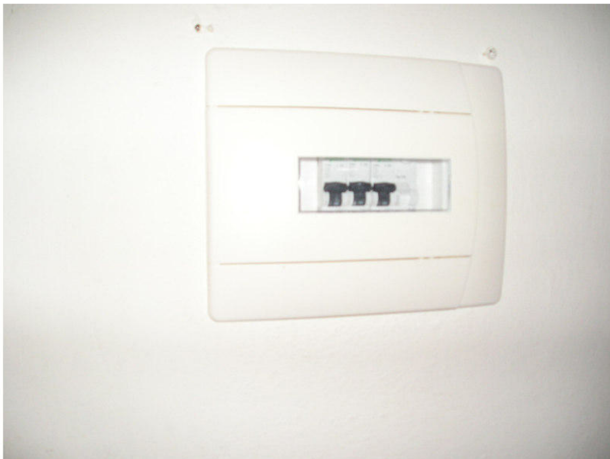
FOTOGRAFIA 27 - Impianti / Quadretto Elettrico
