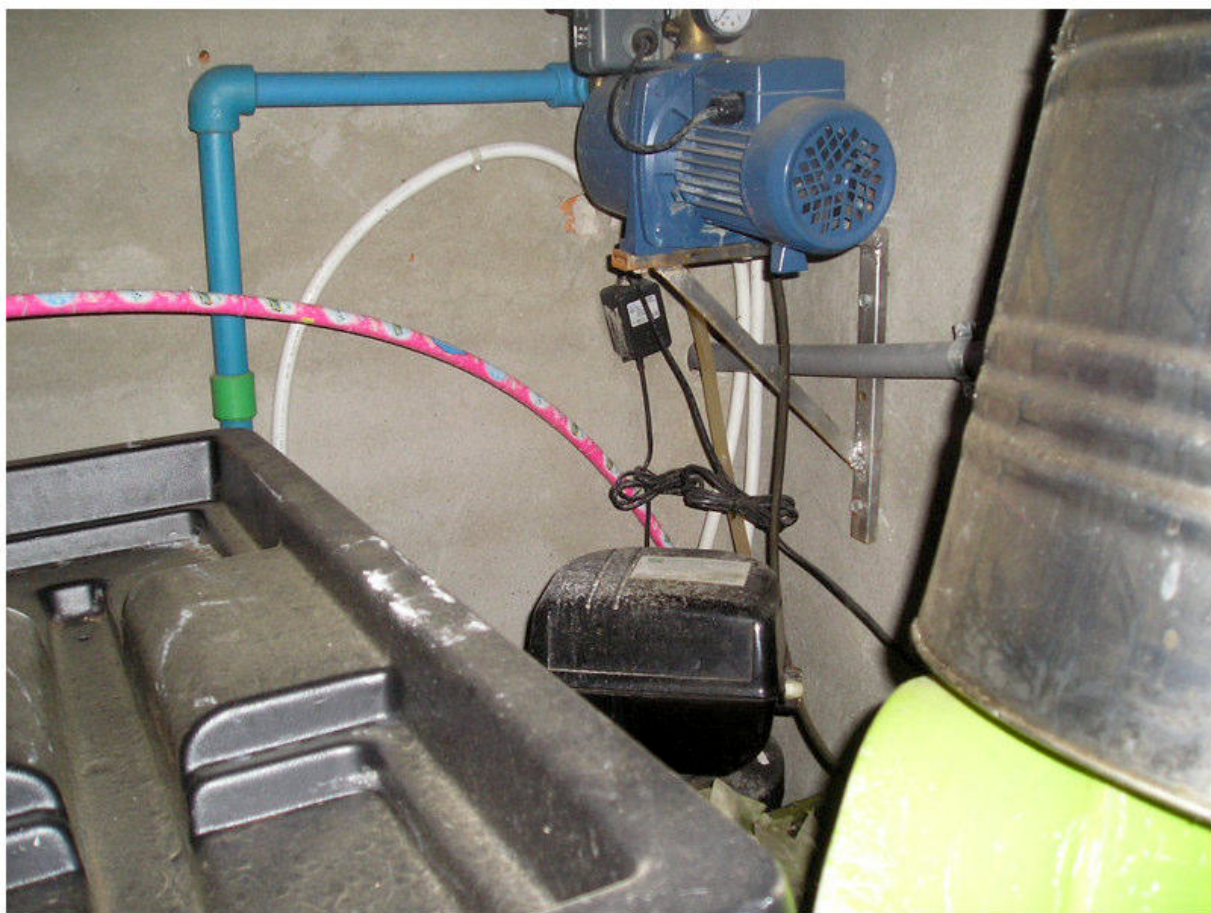
FOTOGRAFIA 29 - Interno Centrale Termica
