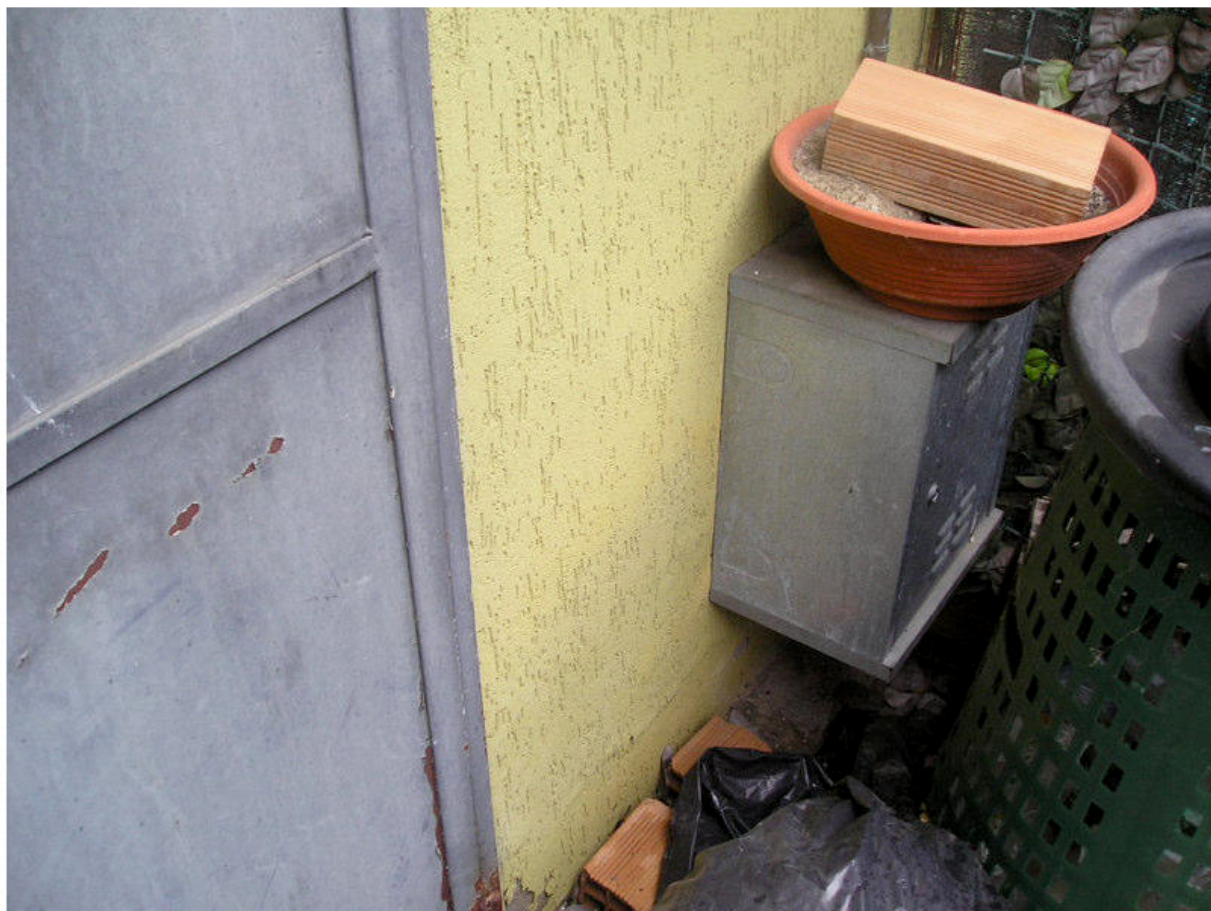
FOTOGRAFIA 26 - Esterno / Contatore Gas
