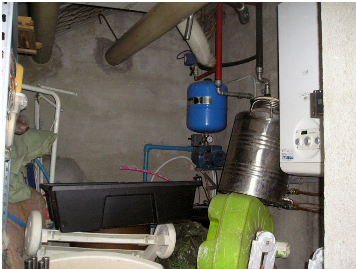
FOTOGRAFIA 30 - Interno Centrale Termica
