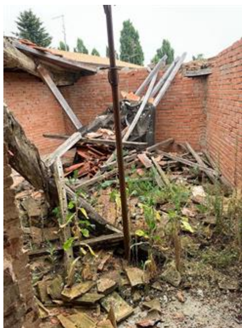
Piano 2° Copertura crollata
