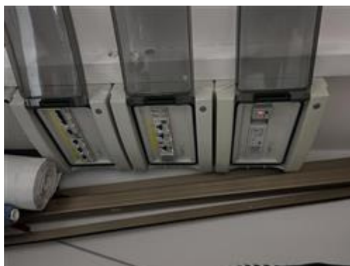
4-Dettaglio quadri elettrici
