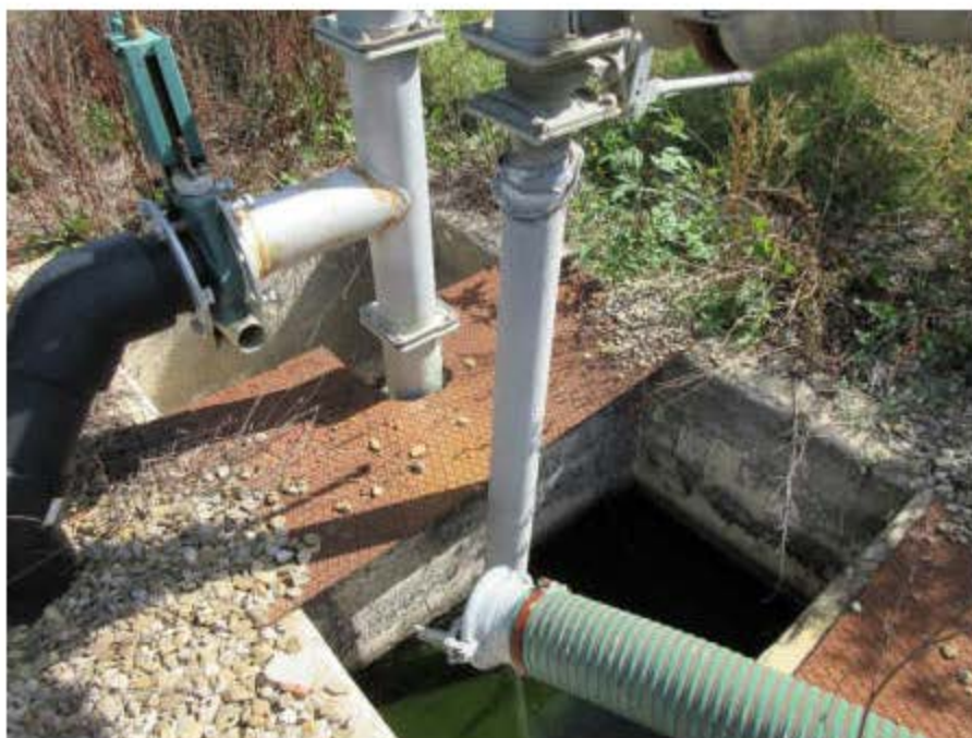
Foto 55 – Area Ecobag – digestato
