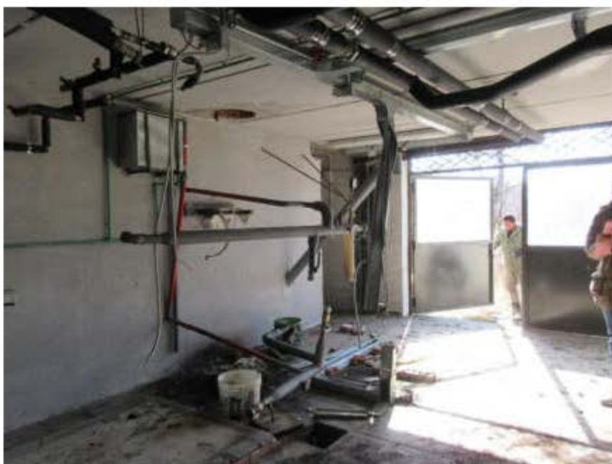
Foto n. 22 – Edificio D – impianti
