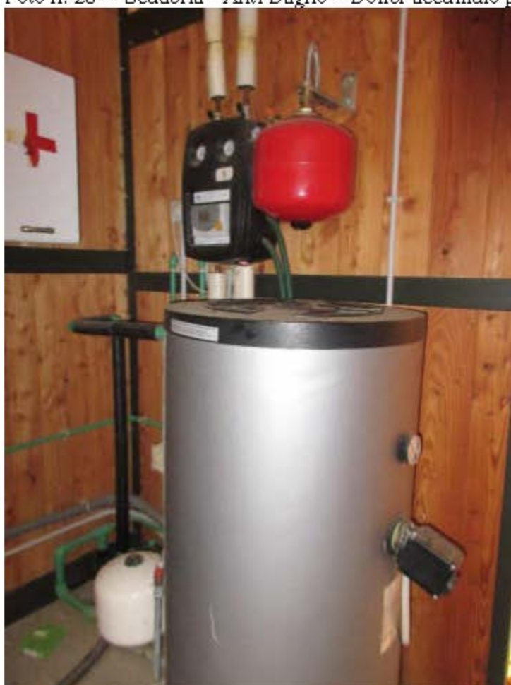
Foto n. 28 – Scuderia - Anti Bagno – Boiler accumulo pannello solare
