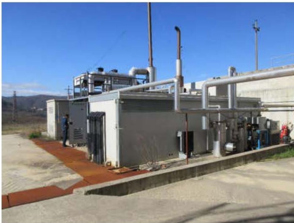
Foto 61 – cabine trasformazione - cogenerazione
