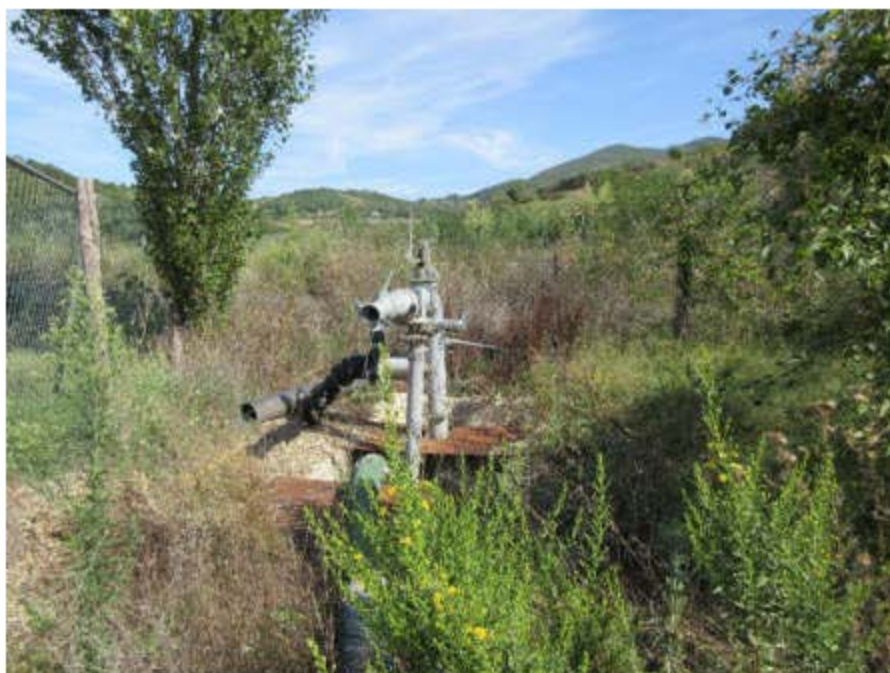
Foto 54 – Area Ecobag - digestato
