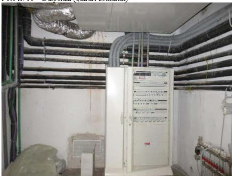
Foto n. 10 – Dispensa (quadri comandi)
