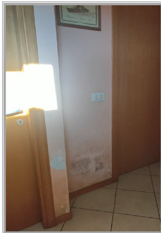
Fotografia 15 – Dettaglio umidità corridoio
