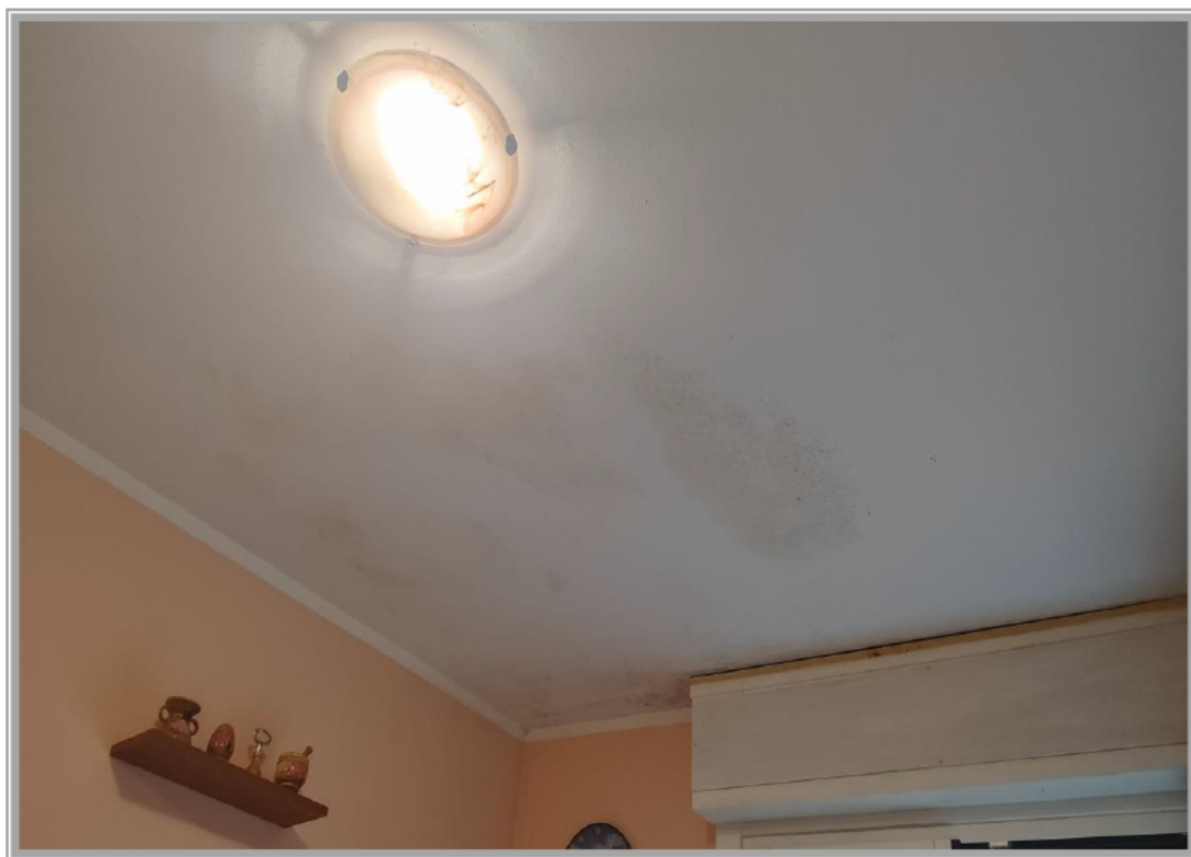
Fotografia 10 – Dettaglio condensa soffitto cucina
