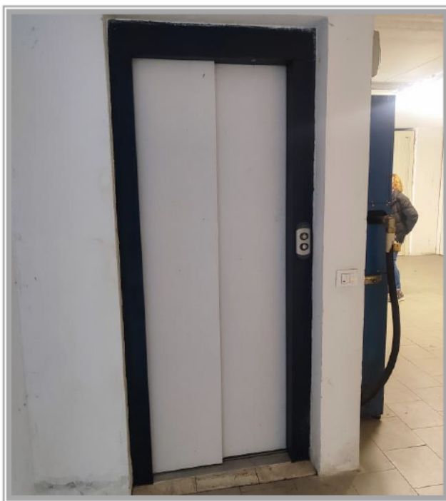
Fotografia 13 – Vista ascensore piano interrato
