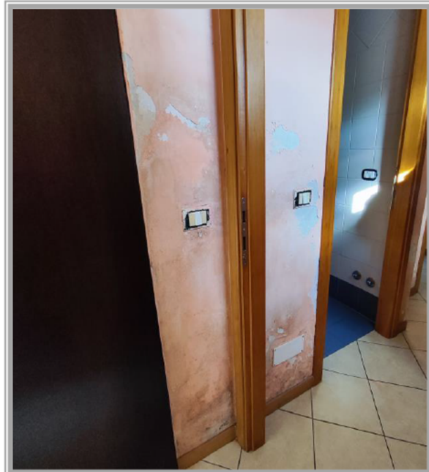
Fotografia 6 – Dettaglio umidità e sbollature
