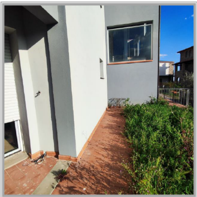
Fotografia 3 – Stato pavimentazione resede
