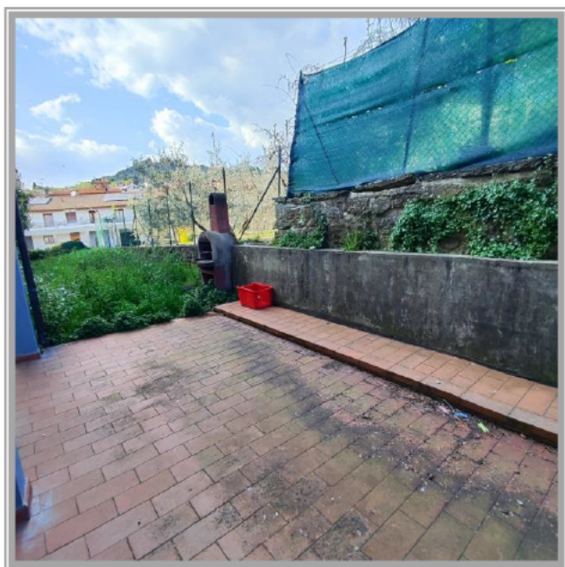
Fotografia 1 – Stato pavimentazione resede
