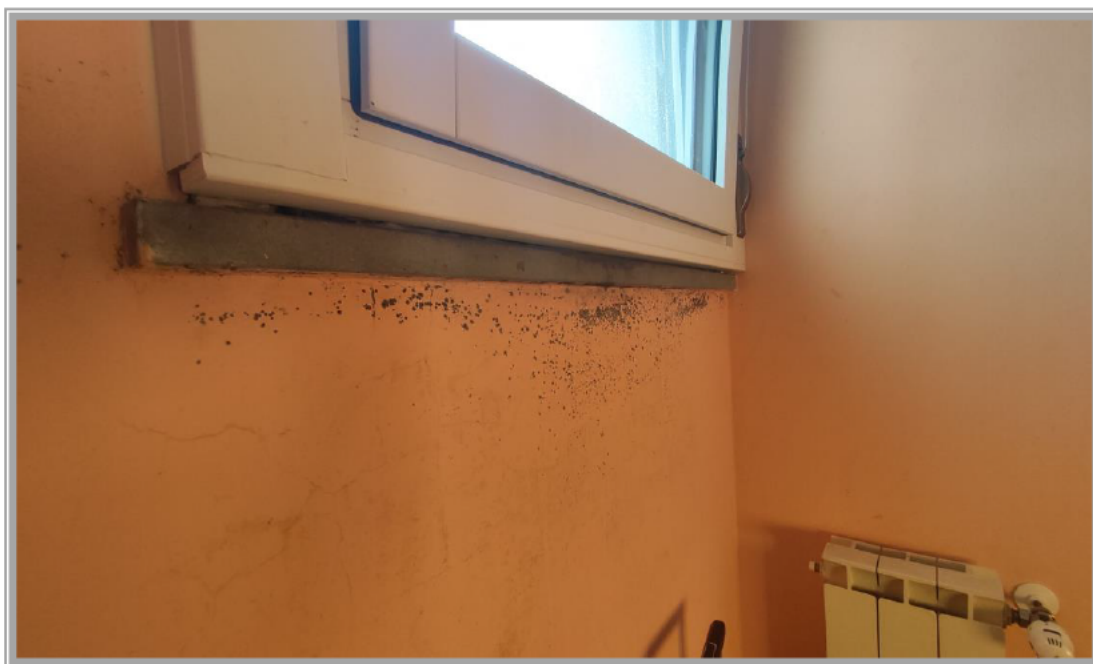
Fotografia 13 – Dettaglio muffa zona installazione nuovi serramenti
