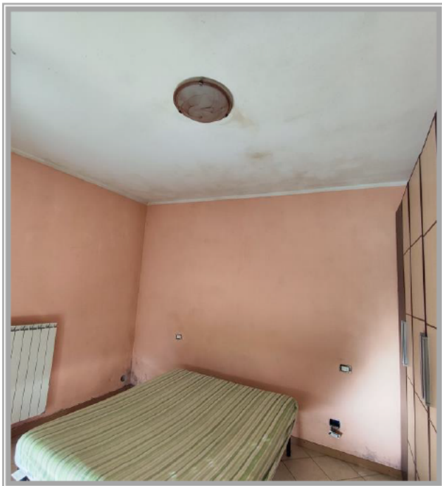
Fotografia 5 – Dettaglio umidità e condensa
