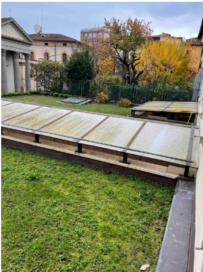
COPERTURA A VERDE UFFICI
