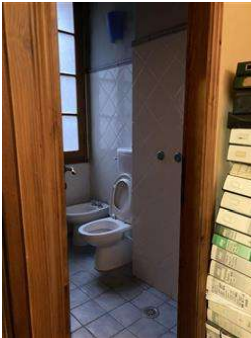
VISTA INTERNA ALL'UNITA'
