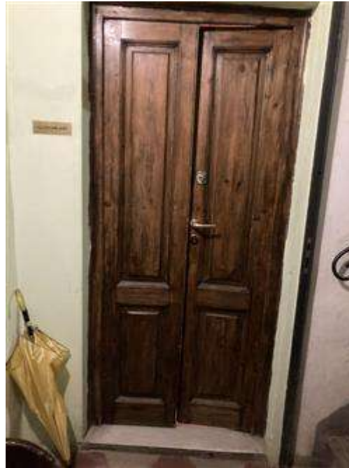
ACCESSO A UFFICIO LATO DESTRO
