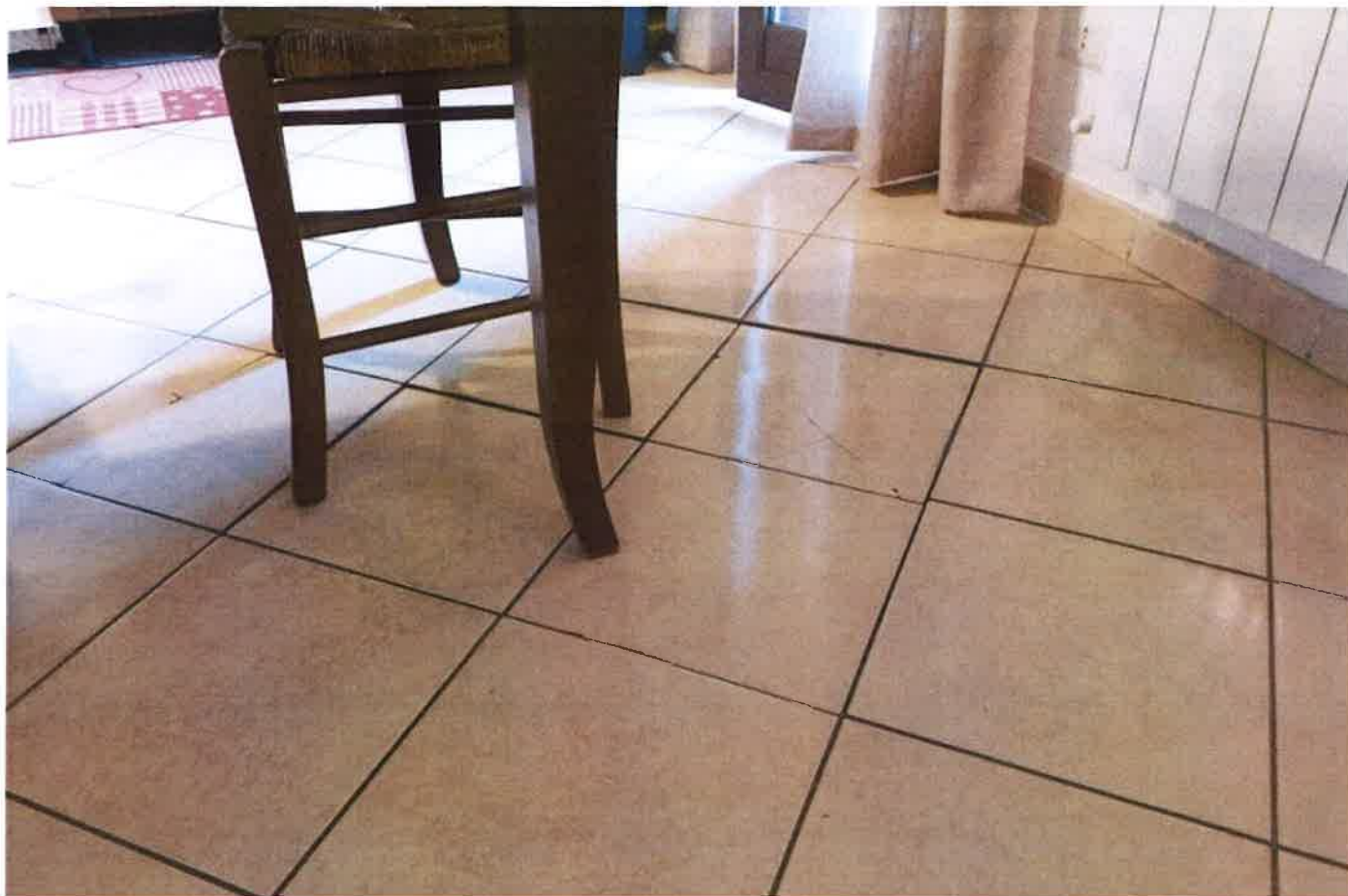
Foto 5 - Particolare sulla pavimentazione con evidenti problemi
