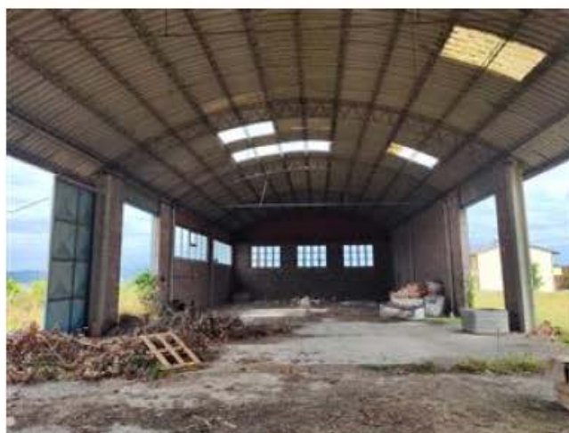
Magazzino in stato di abbandono
