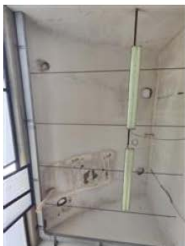
Infiltrazioni dal soffitto dell'ufficio
