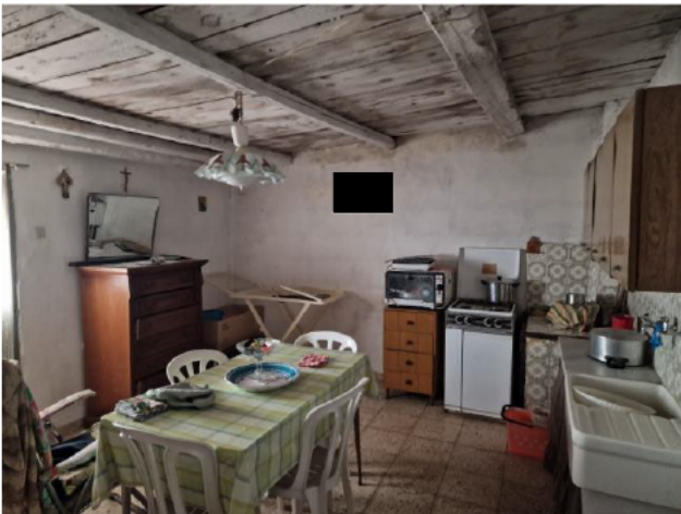
Vano non autorizzato al piano copertura
